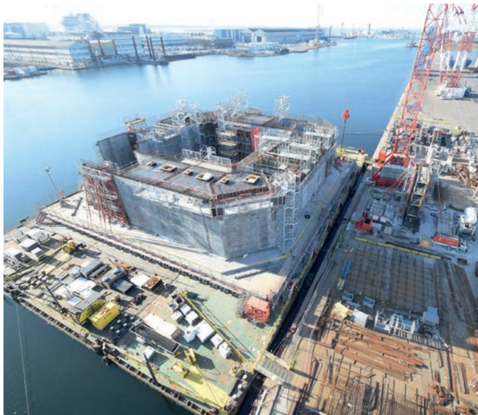
← La fondation flottante Ideol qui équipera l'éolienne Floatgen en construction sur le port de Saint-Nazaire (photo prise le 18 avril 2017).
